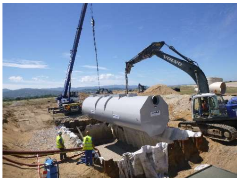
Séparateurs à hydrocarbures
